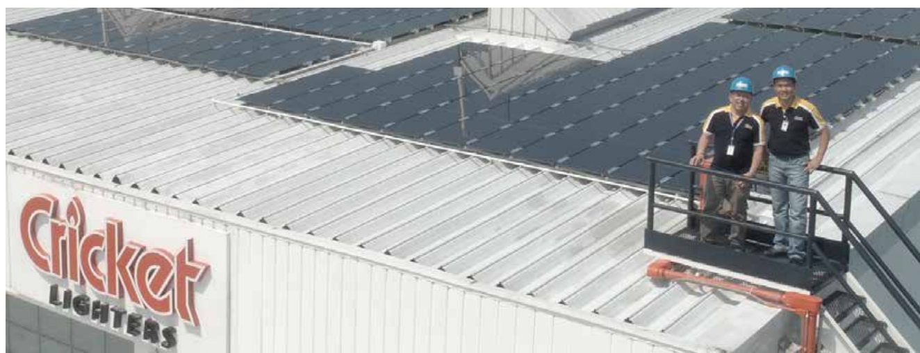
Under det gångna året har Swedish Match vidtagit ett antal positiva åtgärder för att minska utsläppen av växthusgaser. Ett exempel är installationen av solpaneler på produktionsanläggningen för tändare på Filippinerna.
